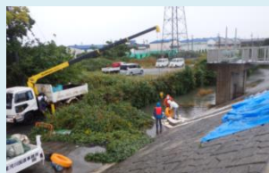
津市高茶屋排水状況
