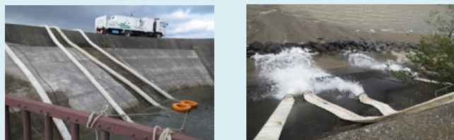
松阪市高須町排水状況
