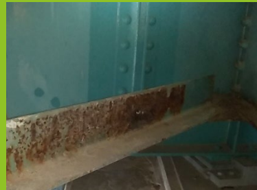
橋梁点検で部材の腐食発見
