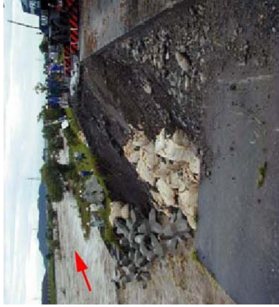
堤防の一部損傷
