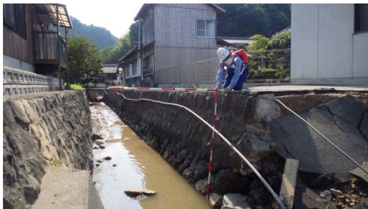
現地での被災状況調査
