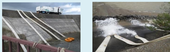
松阪市高須町排水状況
