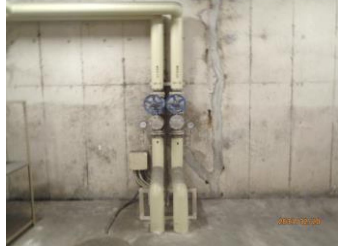
雨水ポンプ設備(6カ所)
