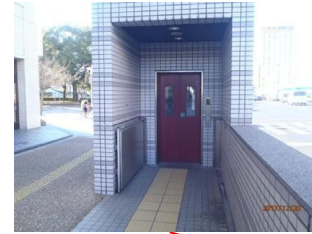
エレベーター(防水板)
