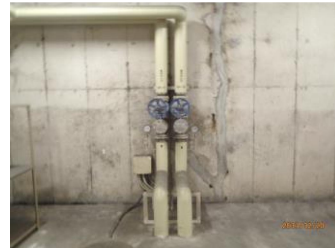
雨水ポンプ設備(6カ所)
