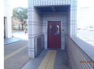
エレベーター(防水板)
