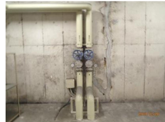
雨水ポンプ設備(6カ所)
