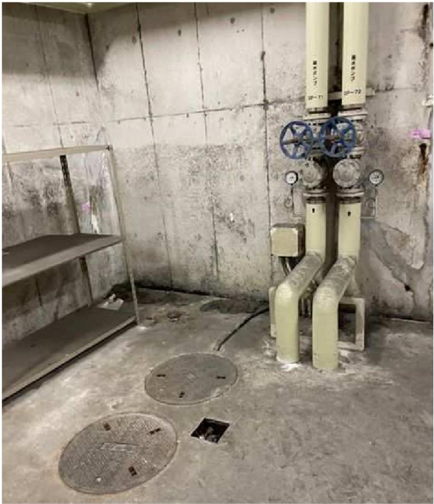
雨水ポンプ 560 (L/分)
