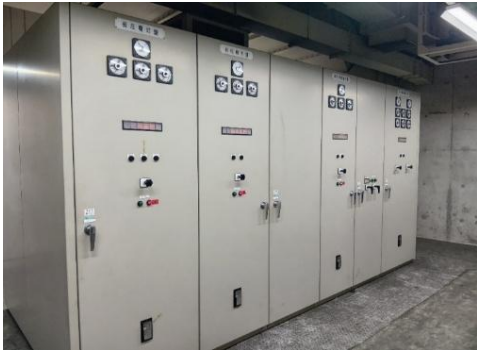
受変電設備（災害前）
