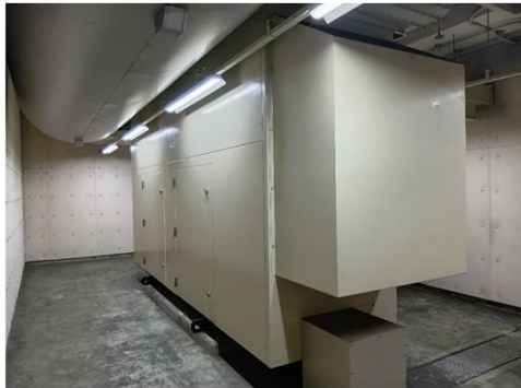
発電機（災害前）
