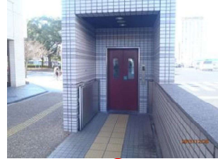
エレベーター(防水板)
