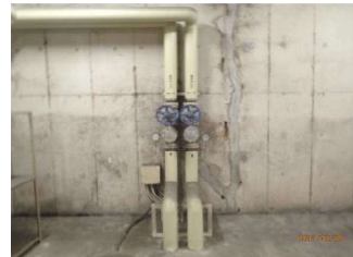
雨水ポンプ設備(6カ所)
