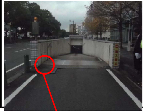
■ 出庫口地上側側溝 路面冠水検知装置
