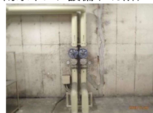
雨水ポンプ設備(6カ所)
