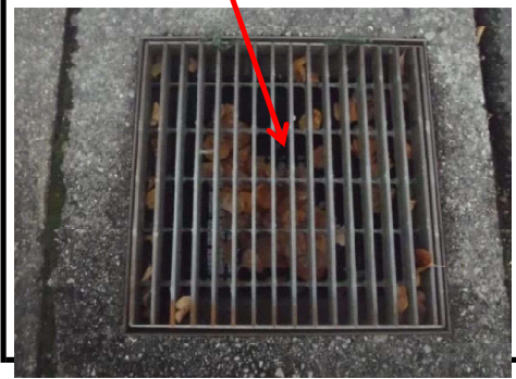
■ 出庫口地上側側溝 路面冠水検知装置
