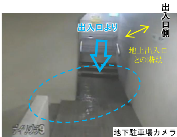
地下1階への浸水開始状況
