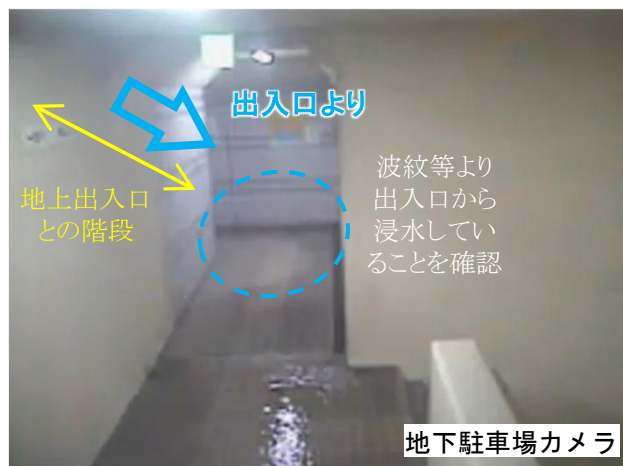
地下1階への浸水開始状況
