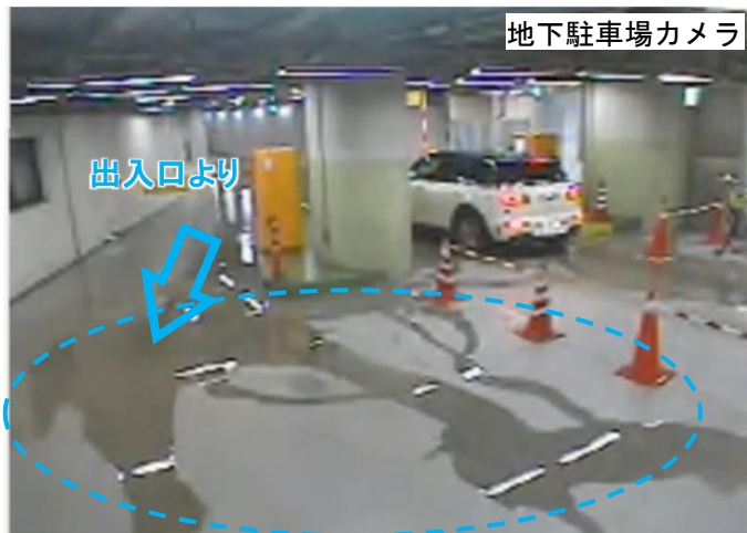
地下1階への浸水開始状況
