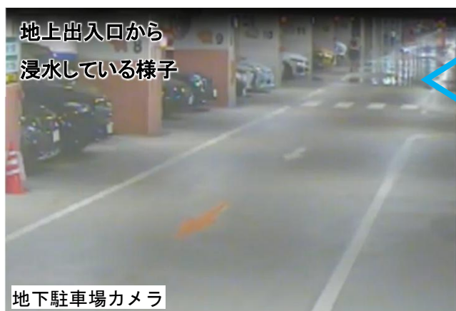
地下1階への浸水開始状況
