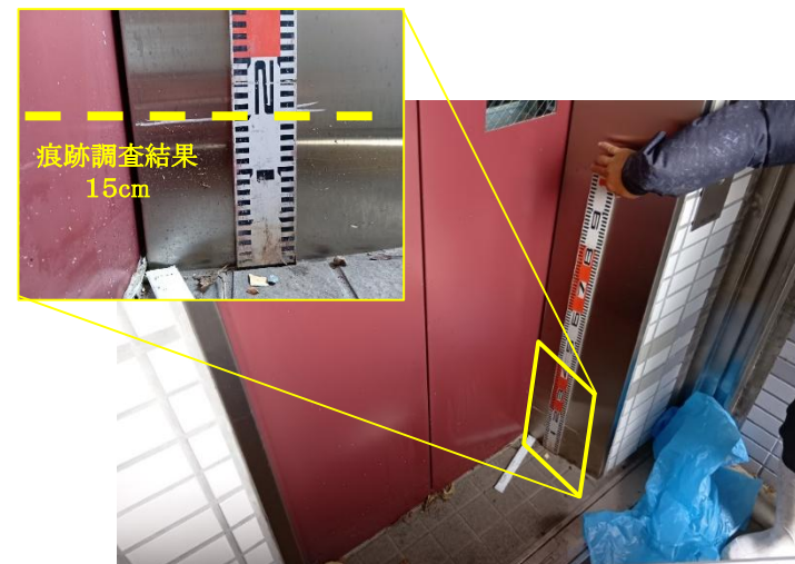
痕跡調査 (9/24:エレベーター出入口)
