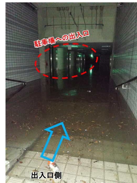
西側出入口(地下1階)の 冠水状況(9/13)
