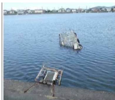
壊れたまま放置された栈橋
