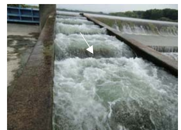
下流延伸区間では、頭首工(水叩き)からの越水が魚道内に流入し、流速が速くなっている。
