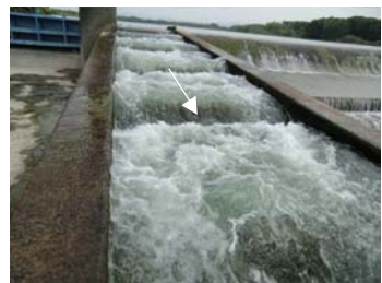
下流延伸区間では、頭首工（水叩き）からの越水が魚道内に流入し、流速が速くなっている。
