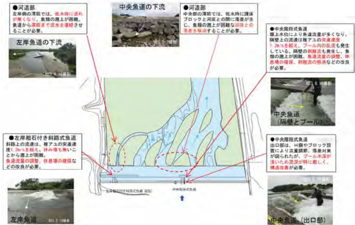
図-3.4 (1) 堰・頭首工の河道及び魚道の課題 (東黒部頭首工)
