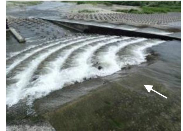
新設・扇形柵田式魚道
