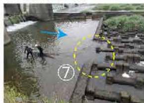
右岸ゲート下流の水叩きと隔壁開口部
