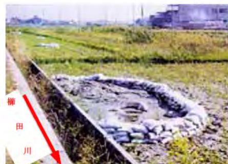
写真2-1-2 漏水の発生状況 平成6年9月洪水により榑田川 2.6k付近左岸で漏水が発生
