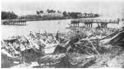
写真 1-1-8 昭和 34 年 9 月洪水 ( 出典：松阪市史 ) 松名瀬橋 ( 松阪市松名瀬町 ) の流失状況
