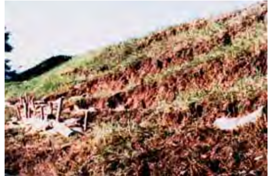
写真 1-1-11 昭和 57 年 8 月洪水 魚見地区 ( 3.8K ) の堤防の裏面崩落状況
