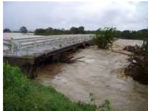
写真 1-1-13 平成 16 年 9 月洪水 大平橋付近の出水状況
