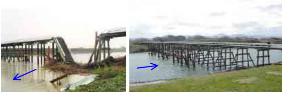
平成 9 年洪水により一部落橋(大平橋)
