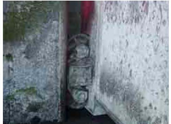
ローラーの腐食が進んでいる。 (写真：昭和43年製作ローラゲート)
