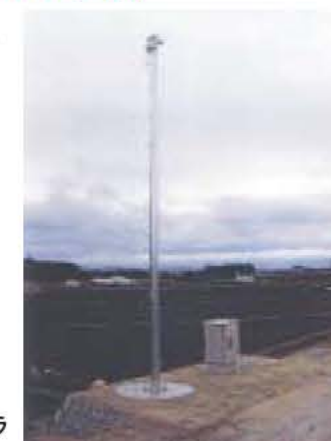
河川監視用カメラ
