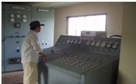
写真 4-3-1 櫛田可動堰の操作状況
