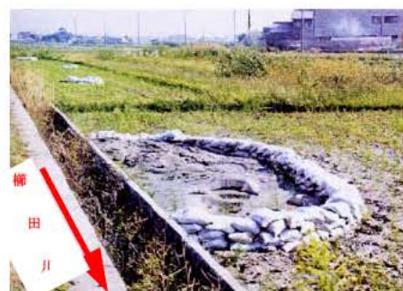
写真2-1-2 漏水の発生状況 平成6年9月洪水により櫛田川 2.6k付近左岸で漏水が発生
