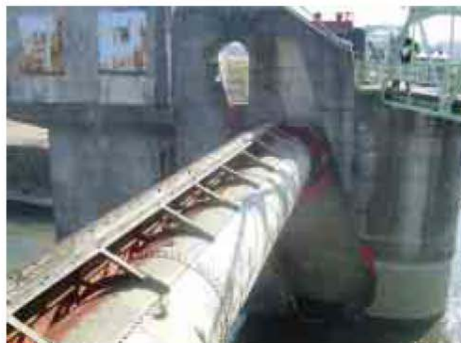
全体的に腐食が進んでいる (写真：昭和29年製作ローリングゲート)
