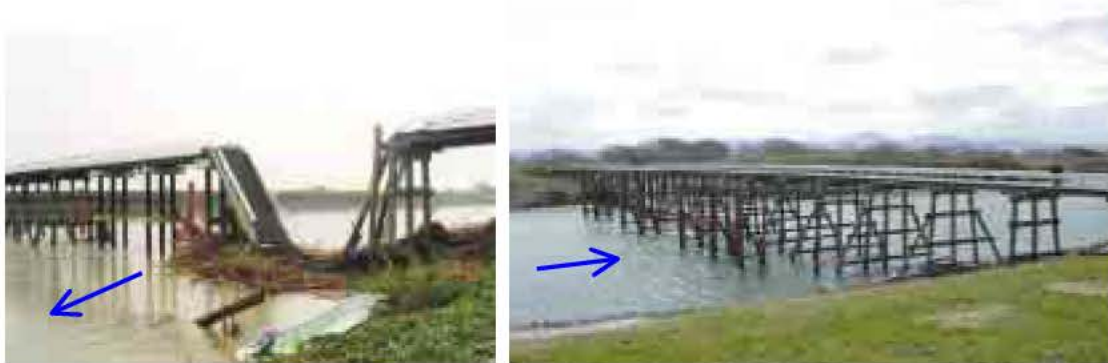
平成 9 年洪水により一部落橋(大平橋)
