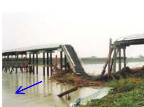
平成 9 年洪水により一部落橋(大平橋)
