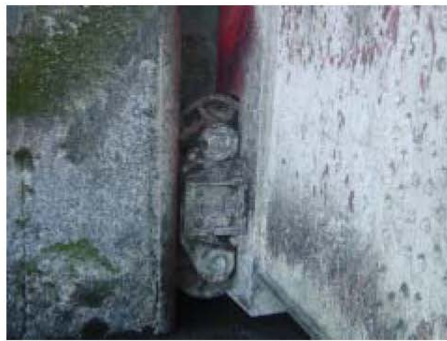
ローラーの腐食が進んでいる。 (写真：昭和43年製作ローラゲート)
