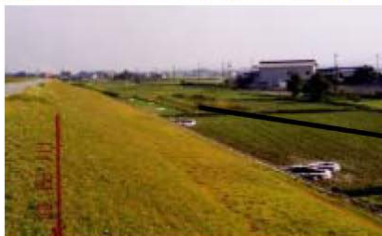
漏水の状況（2.6k 付近左岸）
