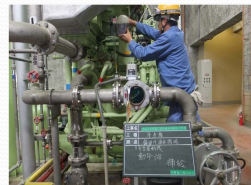
機械設備点検
