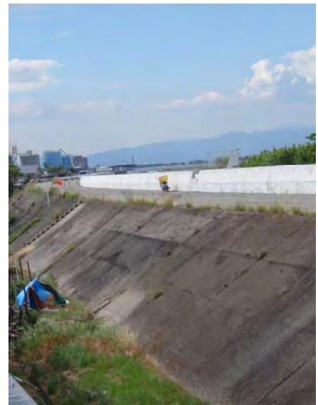
図 2-5 老朽化した高潮堤防 (川裏側未整備)
