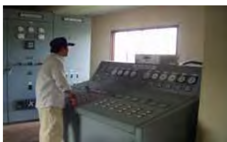
写真 4-3-1 櫛田可動堰の操作状況
