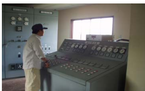
写真 4-3-1 櫛田可動堰の操作状況
