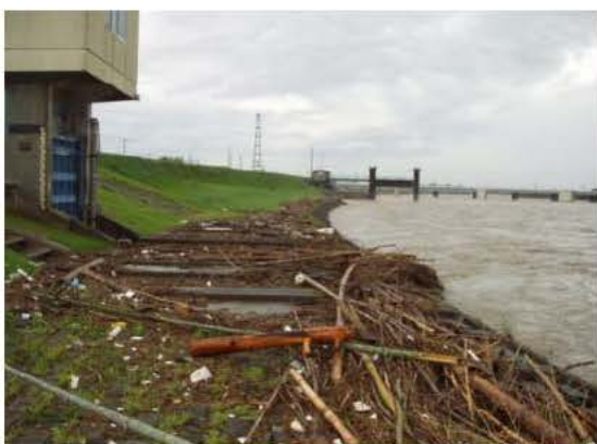
写真 4-3-22 洪水時の流木 平成 15 年 8 月 台風 10 号 櫛田川左岸 8.2k 付近
