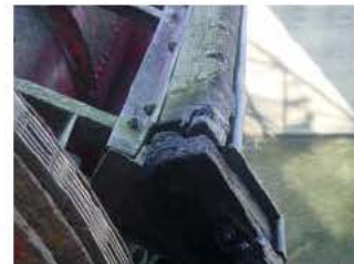
写真 2-1-7 ローリングゲート (木製戸当たりが腐敗している。)
