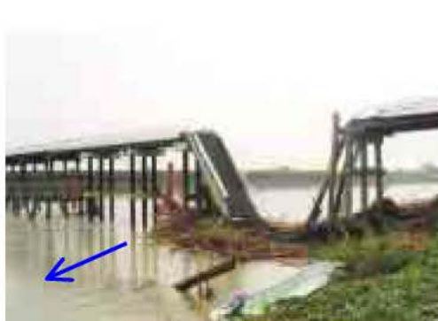
平成 9 年洪水により一部落橋(大平橋)
