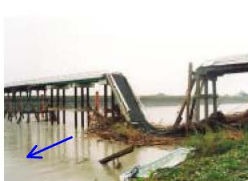
平成 9 年洪水により一部落橋(大平橋)
