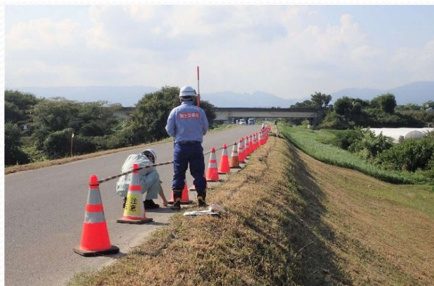
堤防や護岸の変状把握
