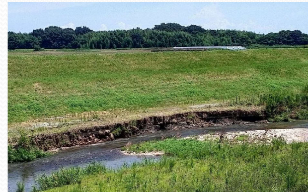
河道内の変状把握(堆積・洗堀等)
