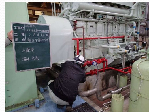
機械設備点検
