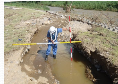
被災状況確認
