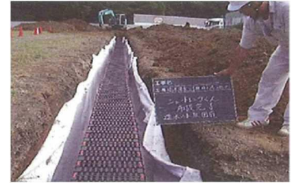
浸透トレンチ
