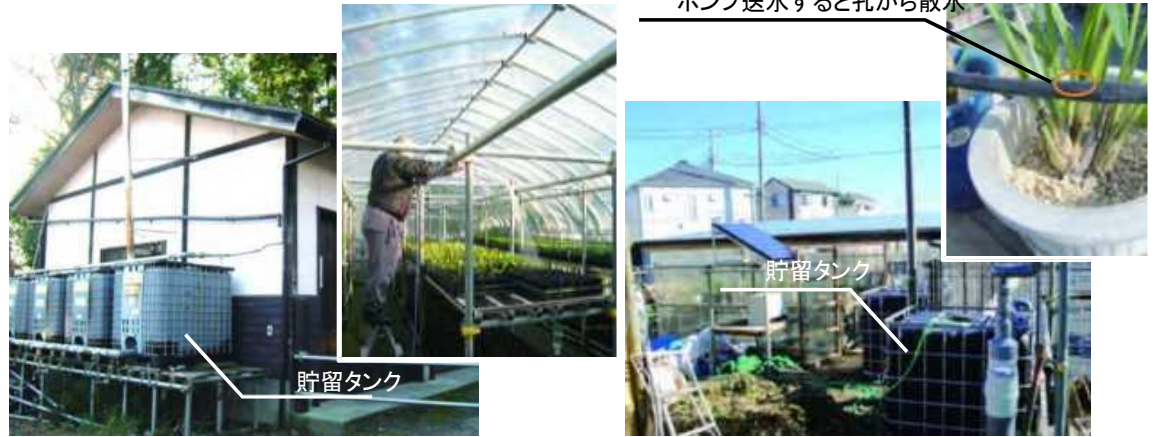
雨水活用施設
