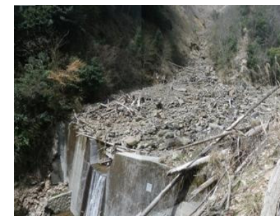
治山ダムが山腹崩壊と土砂流出を軽減した事例【大分県日田市】
