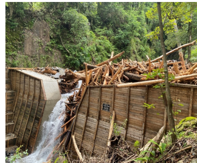
流木捕捉式治山ダムが流木を捕捉した事例【熊本県球磨村】
