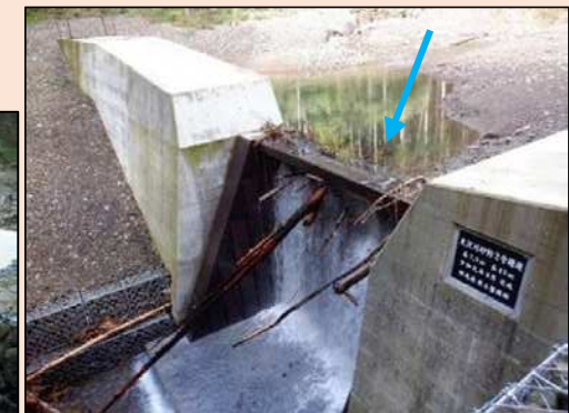
土石流発生後
