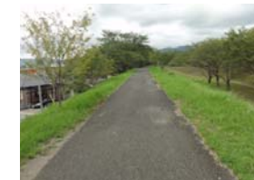
高さ不足・断面不足の堤防 (宮川 右岸6.4k付近)
