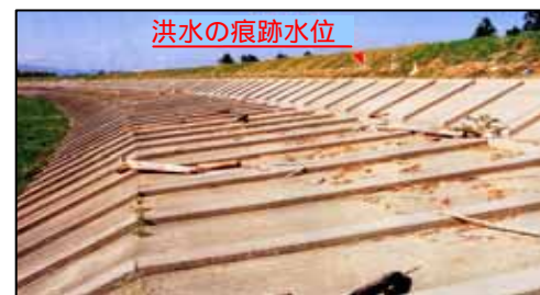
洪水痕跡 (櫛田川右岸3.4k付近)
