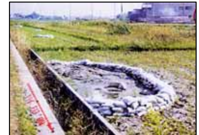
漏水の状況 (櫛田川左岸2.6k付近)
