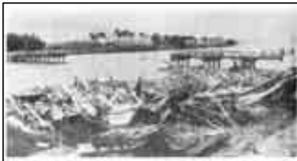
松名瀬橋(松阪市松名瀬町)の流失状況
