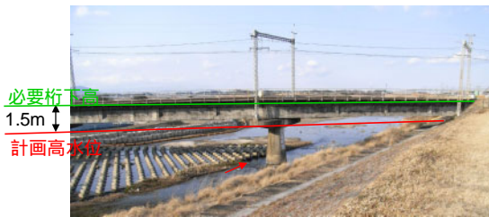
桁下高不足の橋梁（近鉄新中村川橋梁）
