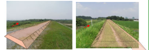
高さ不足の堤防 （雲出川右岸8k付近）
