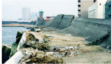
阪神淡路大震災で液状化現象により壊れた淀川の堤防
