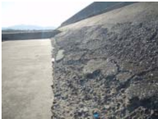
老朽化した高潮堤防 (雲出古川 左岸0.2k付近)
