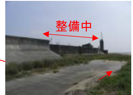
高潮堤防（高さ、断面不足）
