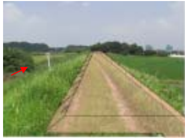
断面不足の堤防 (雲出川右岸12k付近) 15km
