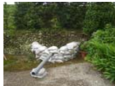
堤体漏水 (宮川の事例)
