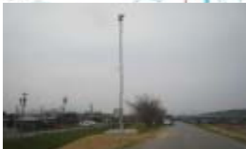
CCTVカメラ（中村川右岸1k付近）
