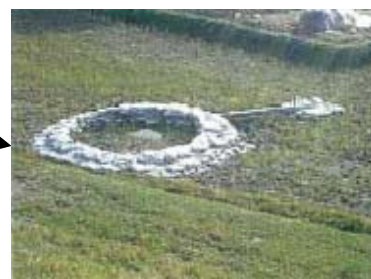
基盤漏水 (雲出川右岸6.2km)
