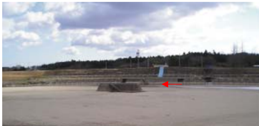
平成16年9月洪水による土砂の堆積状況 (須賀井用水堰付近) [中村川 2.6k付近]
