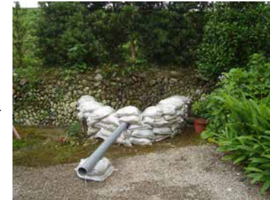
堤体漏水 (宮川の事例)
