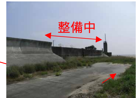
高潮堤防（高さ、断面不足）
