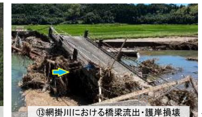
⑬網掛川における橋梁流出・護岸損壊 (鹿児島県始良市)
